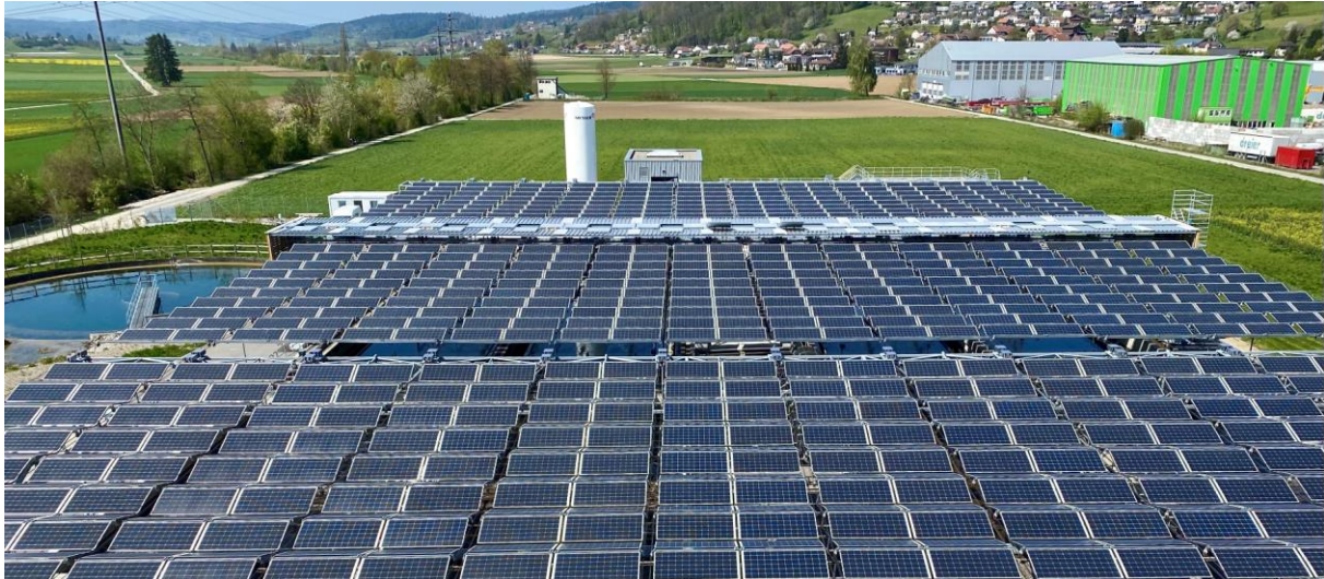
Solarfaldach-Anlage ARA Reinach (AG)
